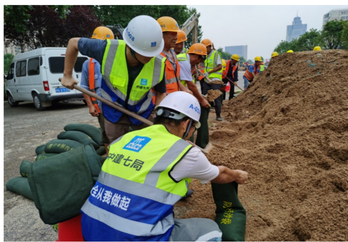
7月22日,中建七局交通公司集结130余人开赴郑州航海西路跨金水河桥塌方现场抢险,图为救援队到达后火速装填防汛沙袋。
